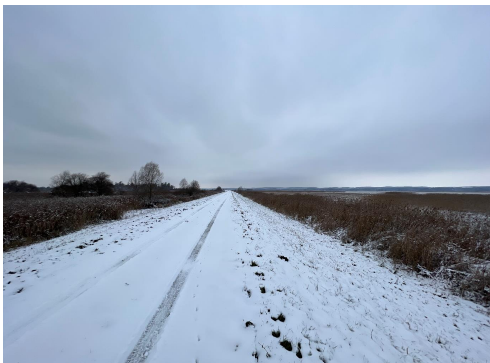
Rysunek 30 Monitoring tropienia na ponowie na wale p. powodziowym wzdłuż rzeki Warty (Fot. Łukasz Cieśliłk).
