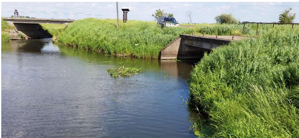
Fot. 30 Lokalizacja podpiętrzenia na moście na kanale pompowni (most z prawej strony) (źródło: opracowanie własne)
