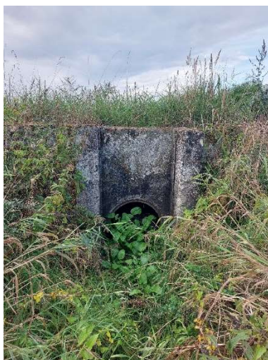
Fot. 32 Przepust 5PP/kp27 wytypowany do odbudowy (modernizacji) (źródło: opracowanie własne)
