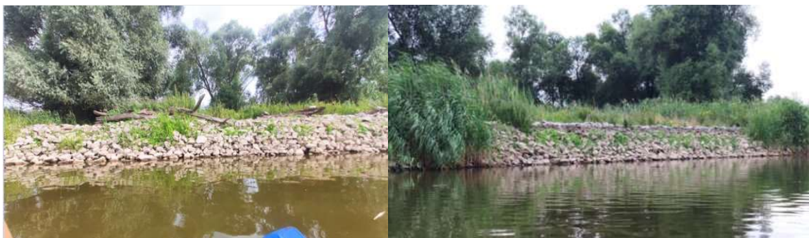
Fot. 24 Umocnienia na prawym brzegu rzeki Warty (źródło: opracowanie własne)
