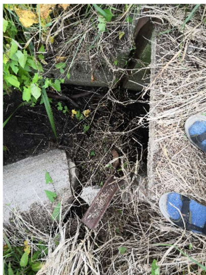
Fot. 31 Przepust 7PP/kp18 wytypowany do odbudowy (modernizacji) (źródło: opracowanie własne)
