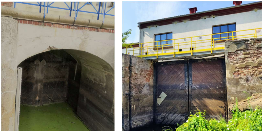
Fot. 11 Wrota grawitacyjne w pompowni Słońsk (po lewej) i Chyrzyno
