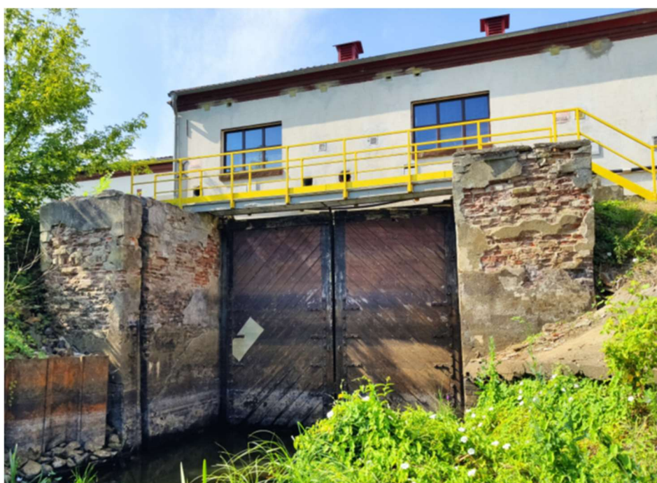
Fot. 20 Zły stan wrót grawitacyjnych zamontowanych w przyległym do pompowni Chyrzyno starym budynku pompowni
