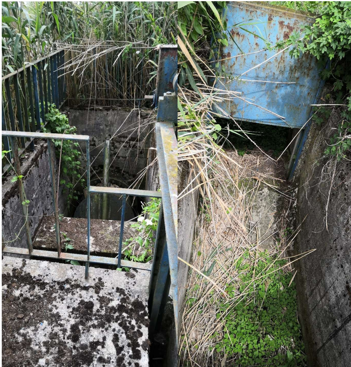
Fot. 27 Istniejący system zasilania Kanału Warnickiego z przepompowni melioracyjnej Witnica (źródło: opracowanie własne)
