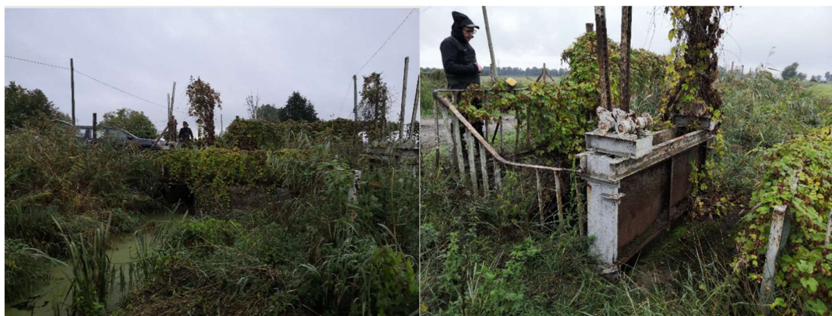
Fot. 29 Węzeł rozdziału wody na rzece Witnej i Kanale Małym (źródło: opracowanie własne)
